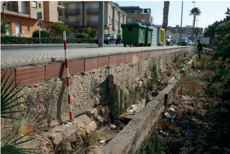
Fig. 14. Carreus formant part de la paret d'una sèquia i per sota d'una vorera reformada recentment a la parcel·la situada al camí del Cementeri núm. 7
